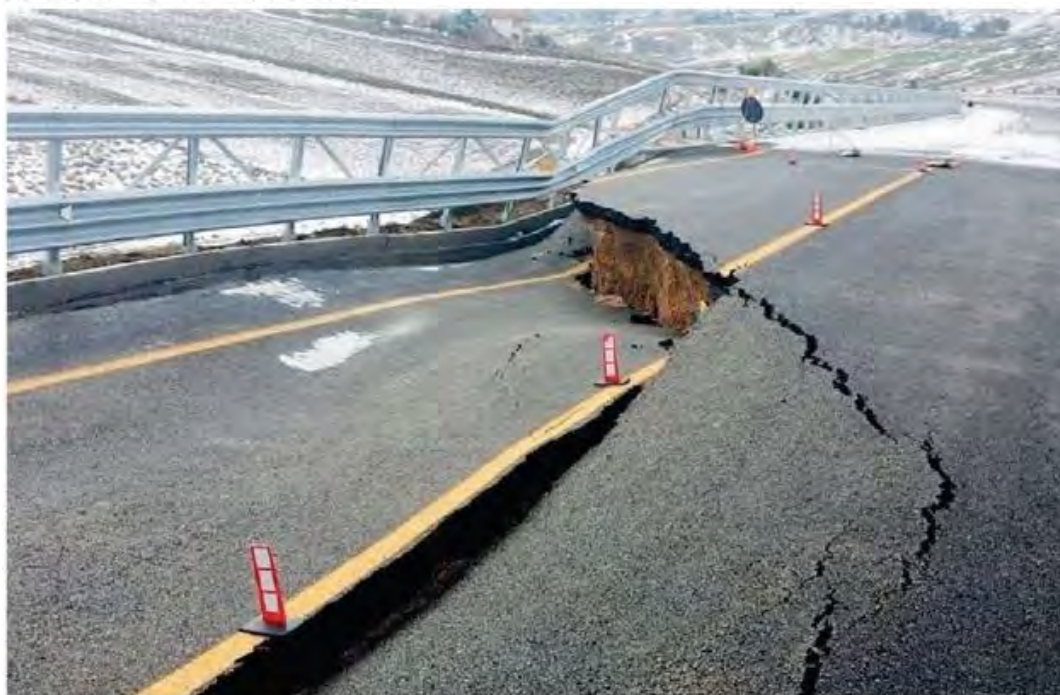
Il ponte crollato sulla statale 189 Palermo-Agrigento pochi giorni dopo essere stato inaugurato
